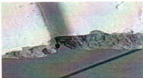
ESQUADRIA DE MADEIRA DANIFICADA
