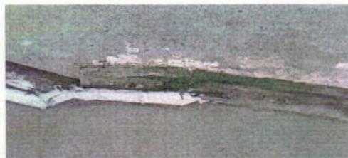
ESTRUTURA EM MADEIRA COMPROMETIDA
