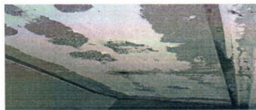
EMBOÇO EM DESPLACAMENTO
